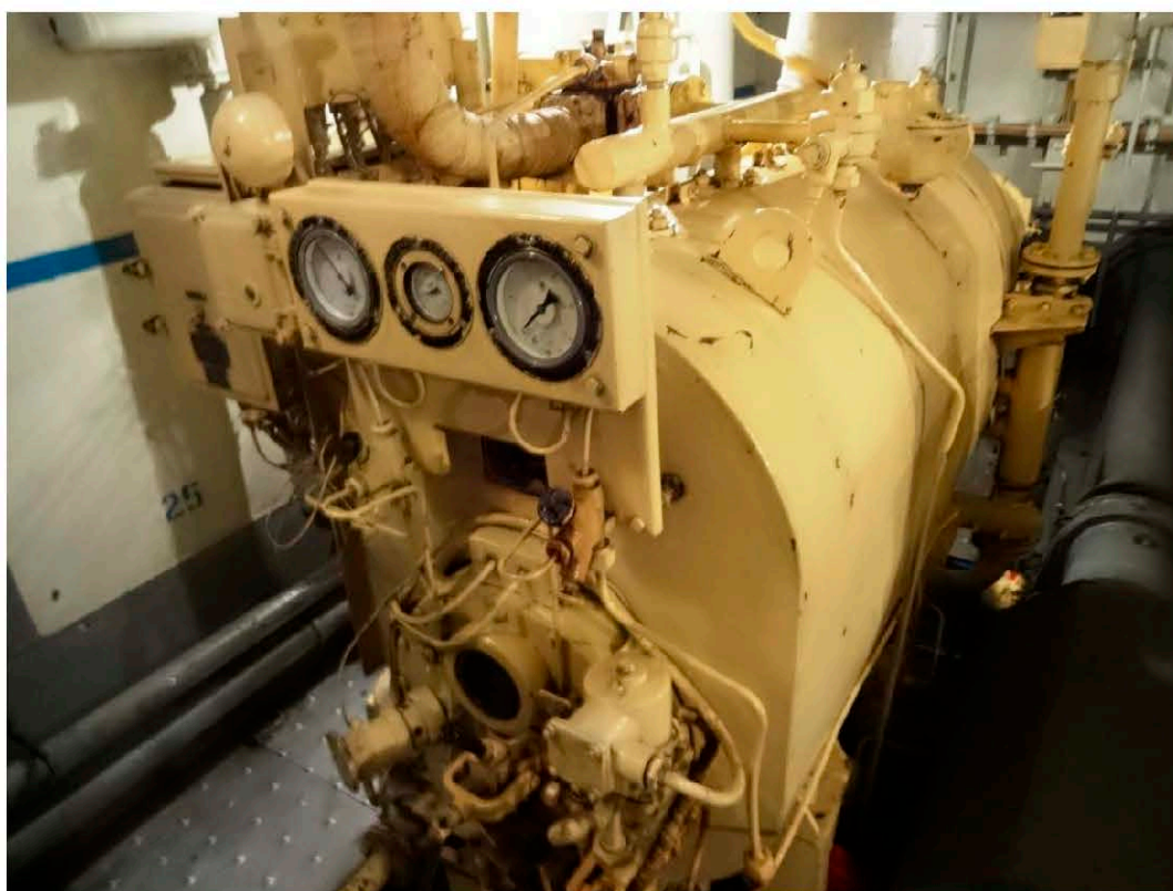
Рисунок 1.4 - Котельная установка КОАВ-68
